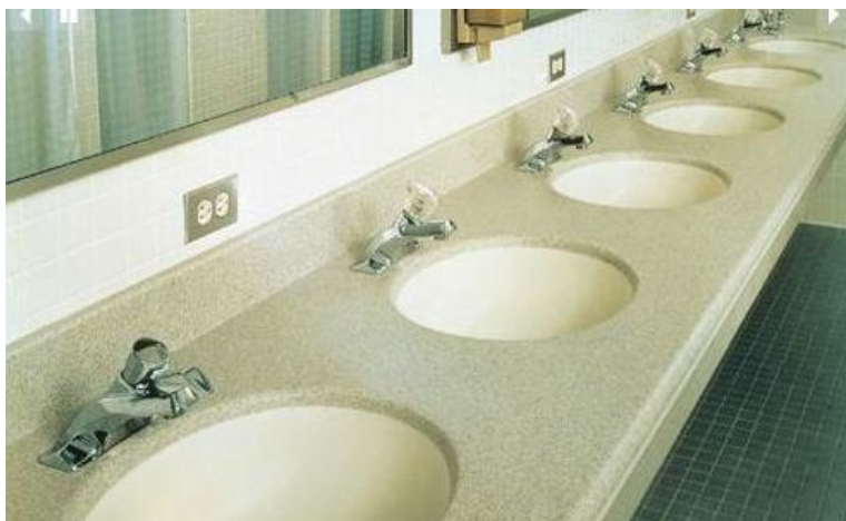
Umywalki podblatowe, montowane do blatu na podkonstrukcji stalowej
